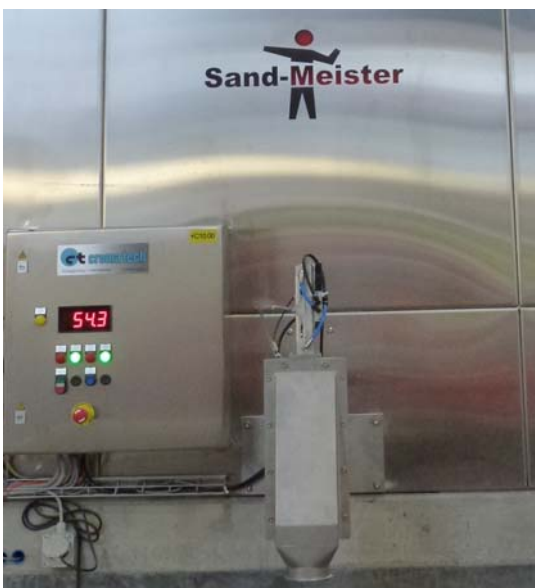
Sand-Silo mit Steuerung und Absperrschieber
