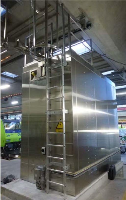
Austragsschnecke FU geregelt Aufstiegsleiter gesichert
